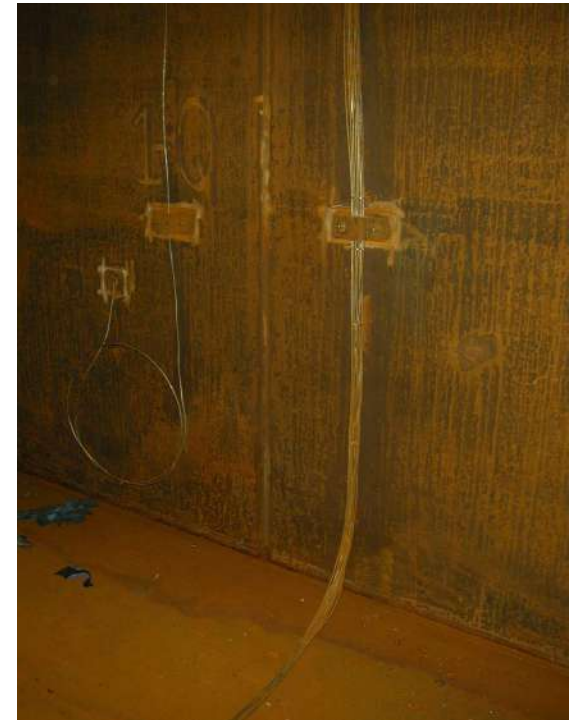
Weld pad sensors in LNG storage tank
